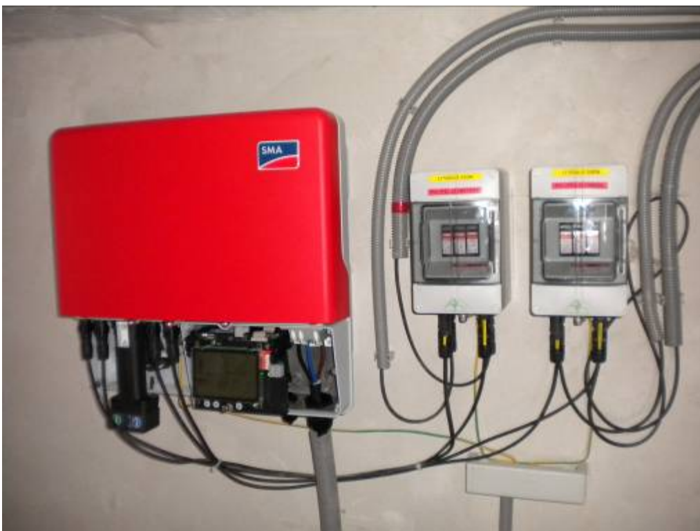
Abbildung 13: SMA Wechselrichter und DC Überspannungsschutz
