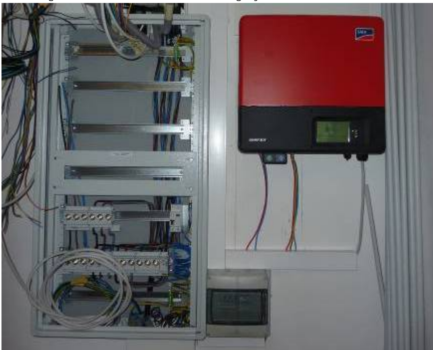
Abbildung 13: SMA Wechselrichter und Sicherungseinrichtungen
