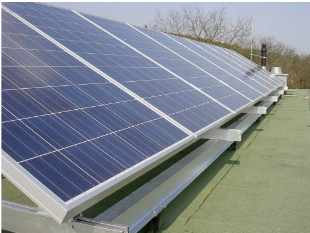
Abbildung 11: Dachansicht PV-Modul Montagesystem
